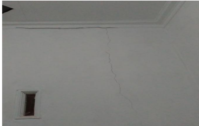
Gambar 1. Retak pada Tembok dan Atap
